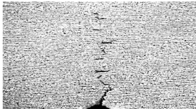
Figura 01 - Microfissuras com acesso externo
